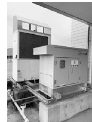
LPガス用室外機と発電機
