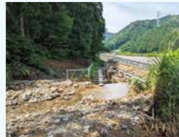
浅見トンネル付近 土砂流出
