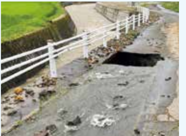
荒谷 道路陥没
