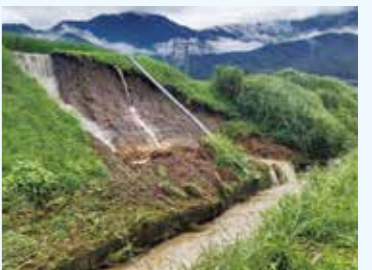
轟團場 法面崩壊
