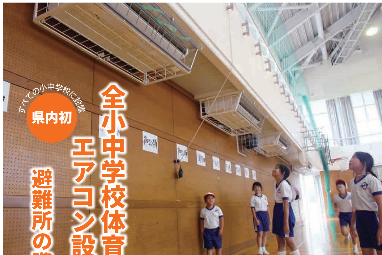
体育館に設置されたエアコンを見る児童たち(御陵小学校)
